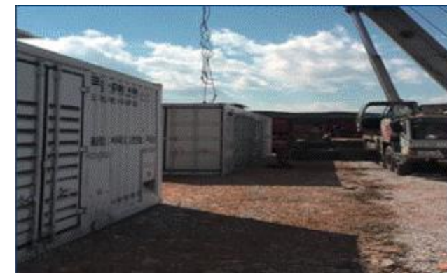
35kV/4MVA新能源测试平台
